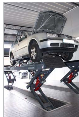
Oben: Die Werkstatt an der Gütersloher Straße befindet sich auf dem neuesten Stand der Technik und ist u.a. mit einer elektro-hydraulischen Hebebühne mit Achsvermessvorrichtung ausgestattet. Das Modell Omer Kar 45 wurde von der Firma GS Wittich montiert.
